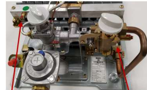
Замер давления газа на горелке
