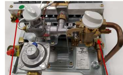
Замер давления газа на горелке
